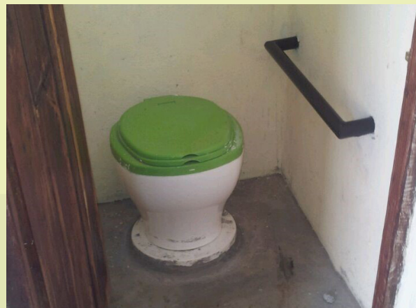
Bloco sanitário com casas de banho separadas para rapazes e raparigas e acesso para crianças com deficiências.
